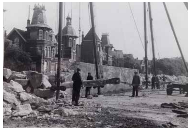
Sloop van de tankmuur langs de Stadhouderslaan (tegenwoordig Eisenhowerlaan) in 1946. Foto: Haags Gemeentearchief
